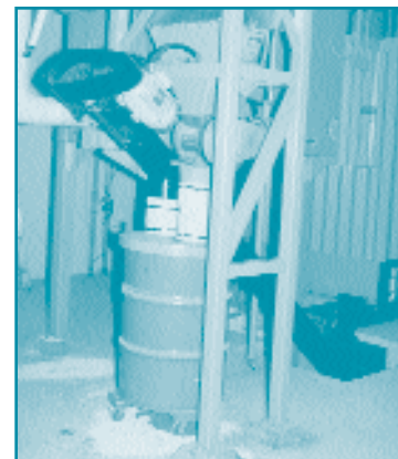
Système d'extraction et de stockage des cendres d'une installation de chauffage à la biomasse automatisé
