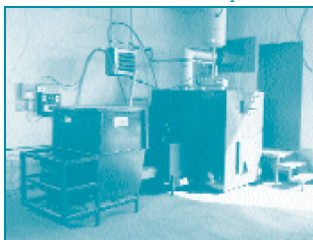
Petit système commercial de chauffage à la biomasse
