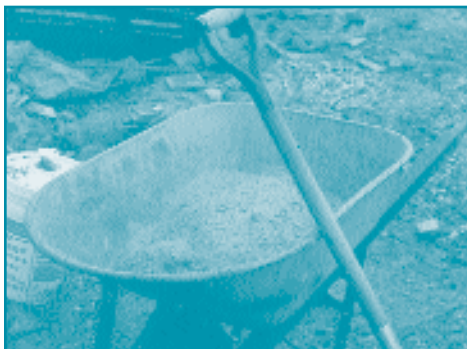
Enlèvement manuel quotidien des cendres produites par une petite installation de chauffage à la biomasse
